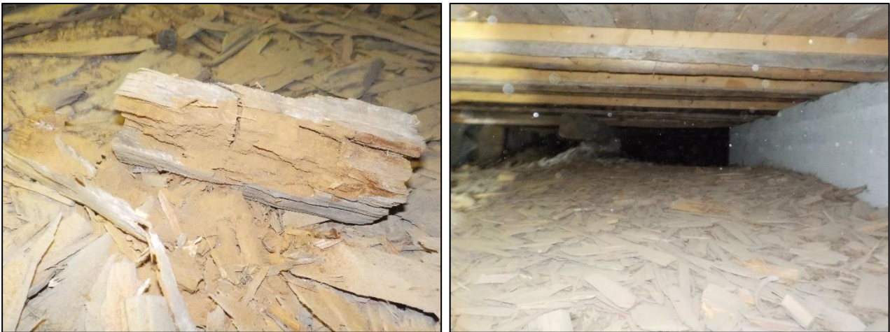
Kuva 2.7. Ryömintätalasta pohjalla on kauttaaltaan paksu kerros puulastuja ja muita puun kappaleita. Puut ovat voimakkaasti lahovaurioituneita.
