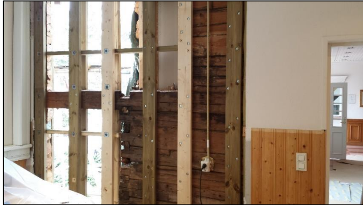
Kuva 2.15. Hirsirungon vaurioiden korjausperiaatetta. Kuvatiedoston päivämäärä 24.7.2013 (lähde: Punkalaitumen kunta).
