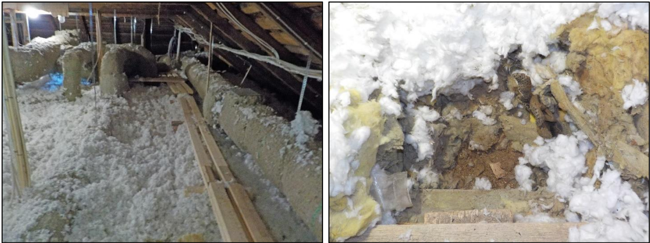
Kuva 2.34. Vasemmalla on yleiskuva yläpohjasta. Nykyisin pinnassa olevan puhallusvillan alta löytyy varsin kirjava valikoima erilaisia lämmöneristeitä: kivivillaa, lasivillaa sekä turvetta ja sammalta.
