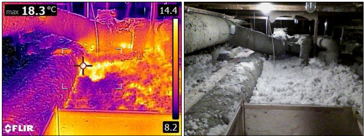
Kuva 2.8. Lämpö- ja ilmavuotoja yläpohjassa.
