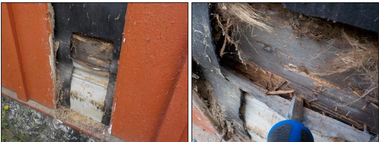
Kuva 2.4. Yleiskuvia rakenneavauksesta AV1: Pellityksen takana ja sen yläpuolella hirressä on lahovaurioita.
