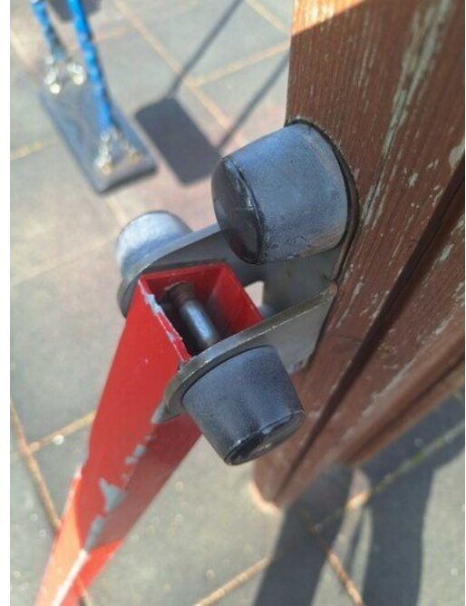
Kuva 7 Putken hattu puuttuu
