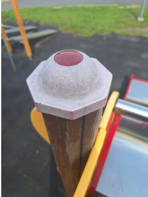
Kuva 24 Tolpan sääsuojat löysät
