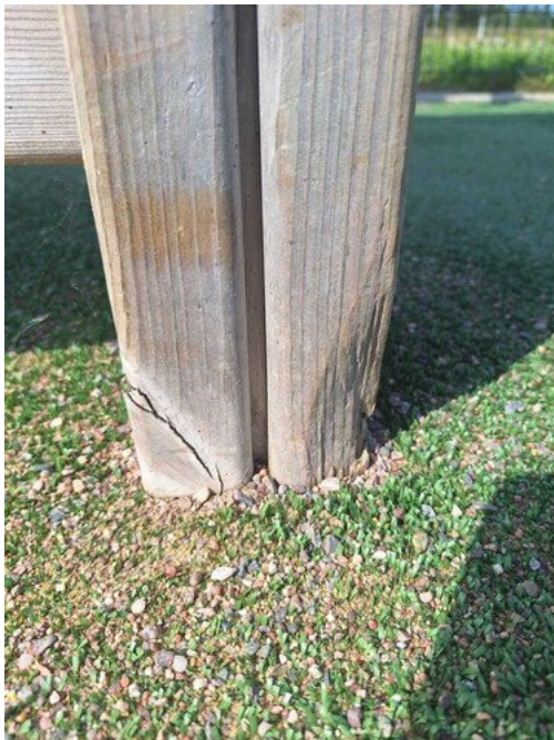
Kuva 34 Tikkuja, puuosasta puuttuu pala
