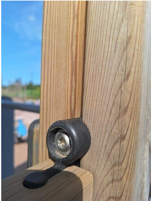
Kuva 28 Mutterinsuojan hattu puuttuu
