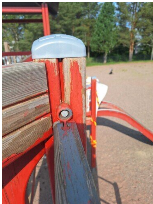
Kuva 6 Mutterin suoja puuttuu
