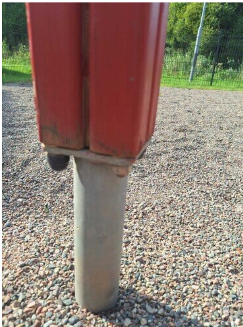
Kuva 3 Mutterin suoja puuttuu
