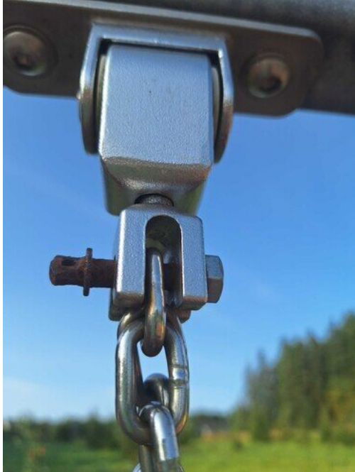
Kuva 40 Kiinnitys ruosteessa, kiinnitys virheellinen
