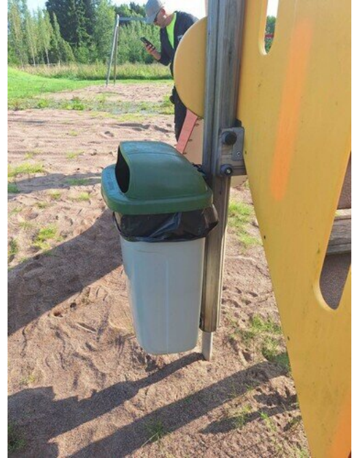
Kuva 50 Roskakori ei voi olla kiinnitetty leikkivälineen tolppaan
