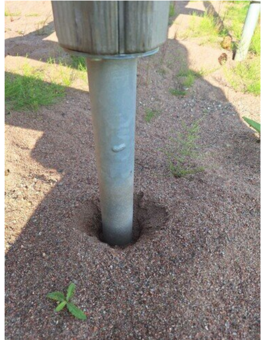
Kuva 75 Asennettu liian korkealle
