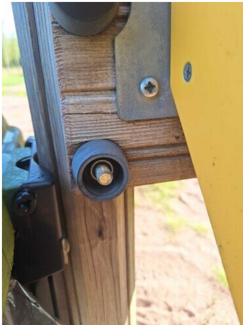
Kuva 44 Mutterinsuojan hattu puuttuu
