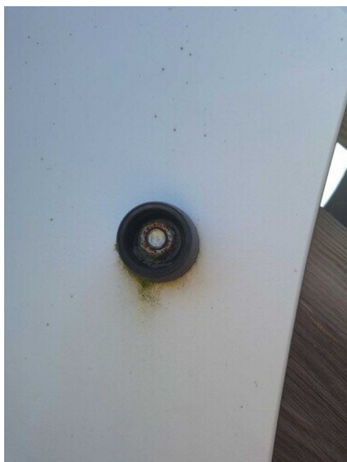
Kuva 73 Mutterinsuojan hattu puuttuu
