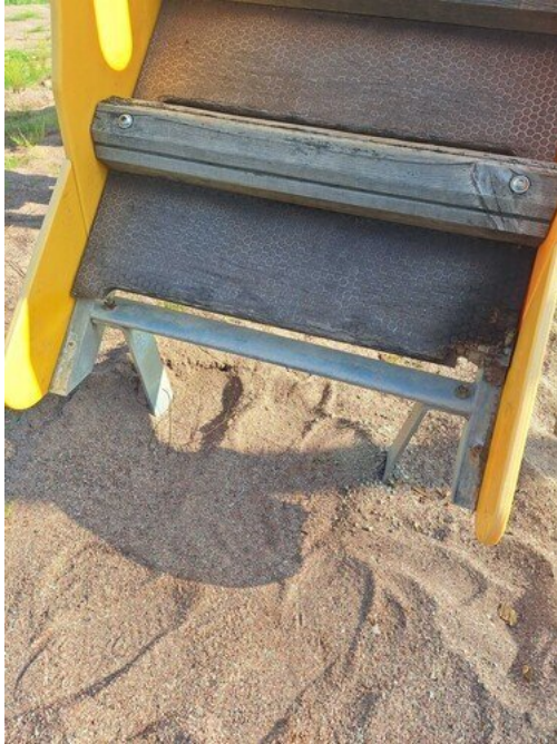
Kuva 49 Vanerista puuttuu pala, mutterin suojat puuttuu, ruuvit näkyvissä
