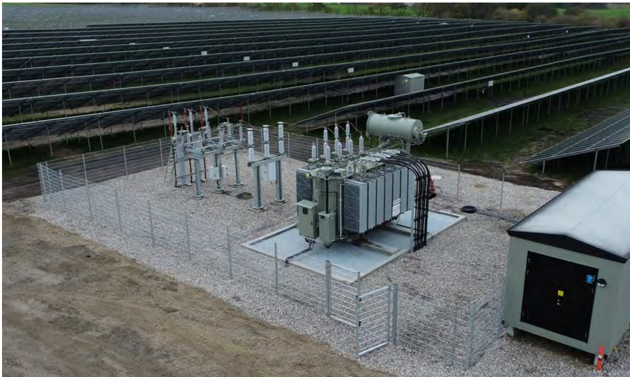
Kuva 8. Esimerkkikuva teollisen mittaluokan aurinkovoimalaitoksen muuntamoalueesta ja paneelikentistä.
