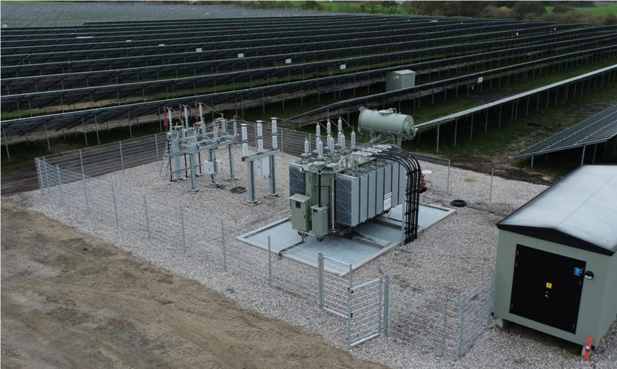
Kuva 6. Esimerkkikuva teollisen mittaluokan aurinkovoimalaitoksen muuntamoalueesta ja paneelientistä.
